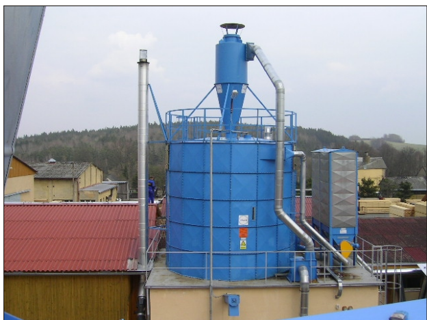
• Silos na paliwo drzewne nad kotłownią - ZP 5000 (výška 5 m) w firmie Bohuslav Turner-pilařská výroba (Myto u Tachova, ČR)
